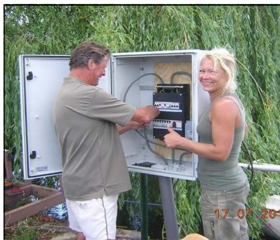
De nieuwe electriciteitskast
